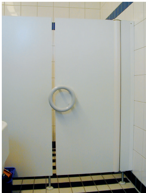
Foto 17: Kabinentür im Sanitärbereich ohne Quetschstellen
